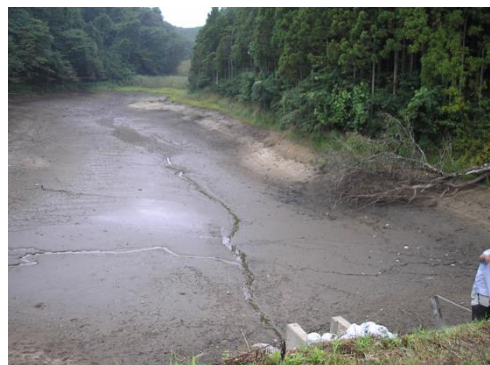
図 7 堰堤の損傷で干出したため池
