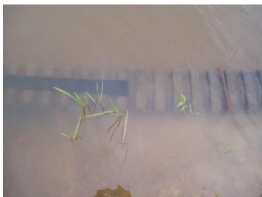
写真－７ 水中に埋没してはだめ
